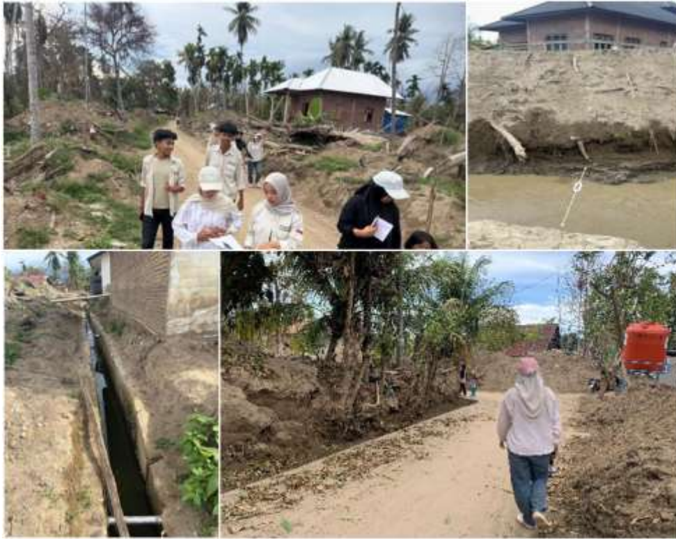
Gambar 8. Kondisi lahan dan kerusakan infrastruktur
